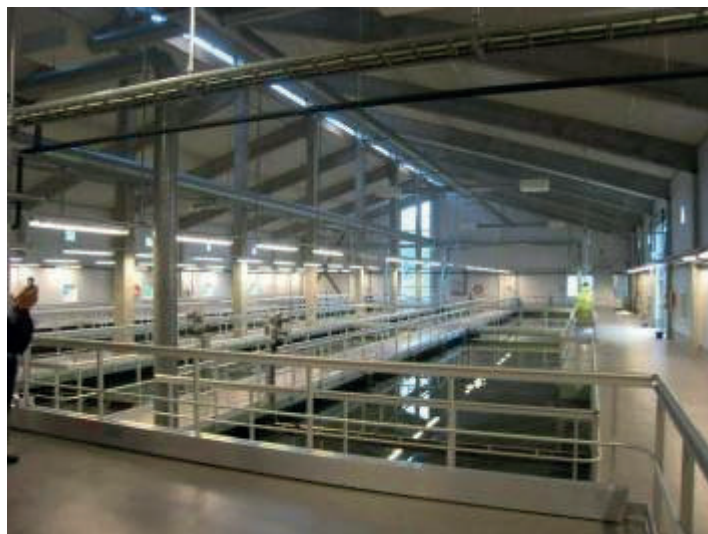
Sedimenteringsbassengene på et kommunalt avløpsrenseanlegg
