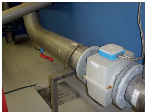
Figur 29. Elektromagnetisk gjennomstrømningsmåler i bruk på et renseanlegg
