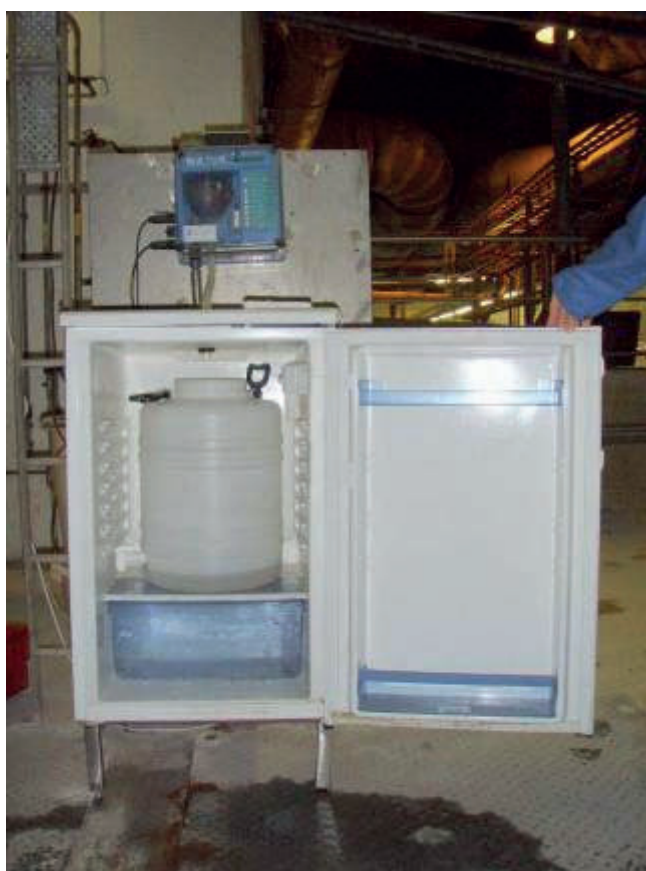
Figur 12. Permanent installert automatisk prøvetaker
