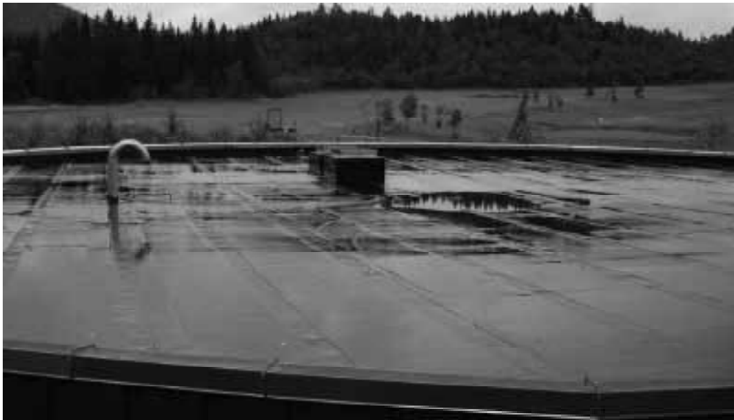
Figur 6.17: Papptekket tak. Fall mot sluk plassert på tak. Nedløp gjennom basseng kan være uheldig og krever rør med varig tette skjøter. Et sluk er tettet med løv.
