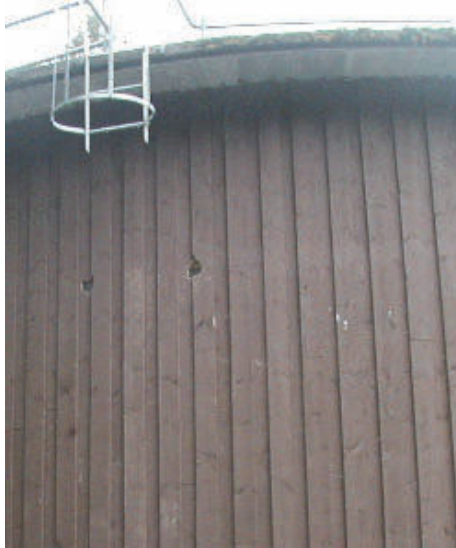
Figur 10.1: Utvendig panel bearbeidet av hakkespett.
