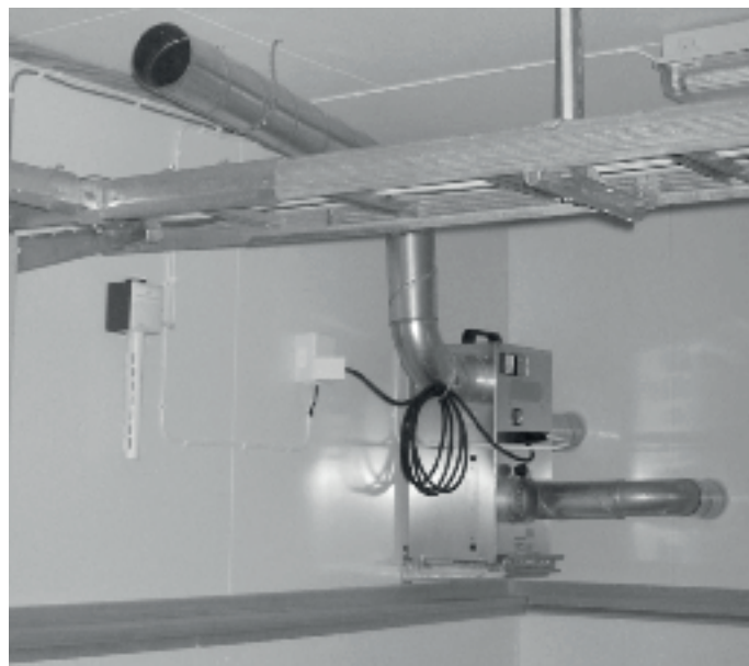
Figur 7.4: Bilde viser en sorpsjonsavfukter plassert i et ventilkammer. Denne tar fuktig luft fra rommet som avfuktes og blåses ut igjen i rommet som tørr luft. Fukt overføres til en annen luftstrøm som blåses ut.
