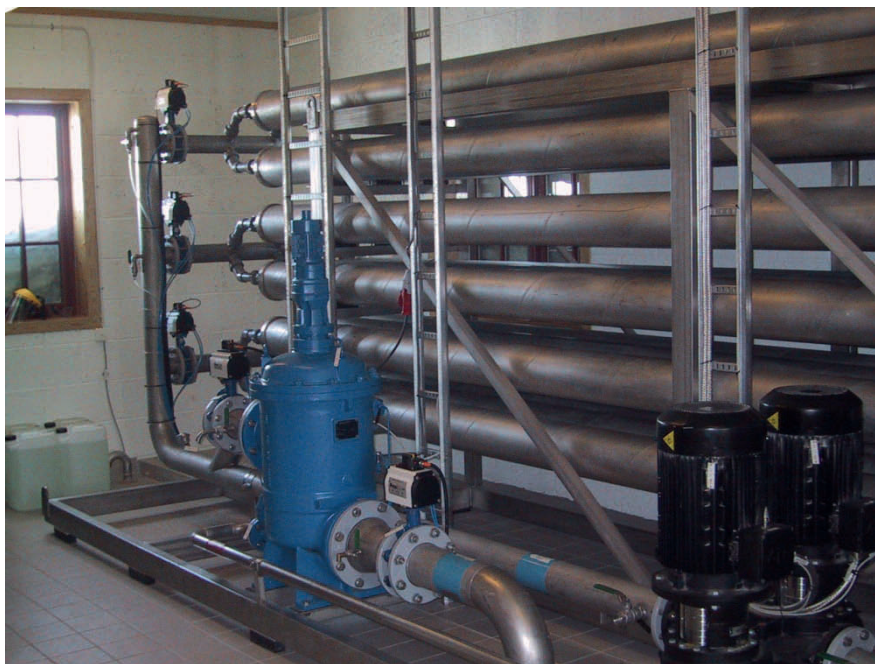
Figur 5. Membranfilteranlegg (med tverrstrøms spiralmembraner)
