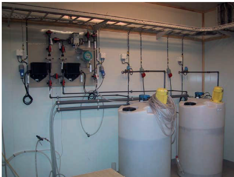
Figur 7. Klordoseringsanlegg (for natriumhypokloritt)
