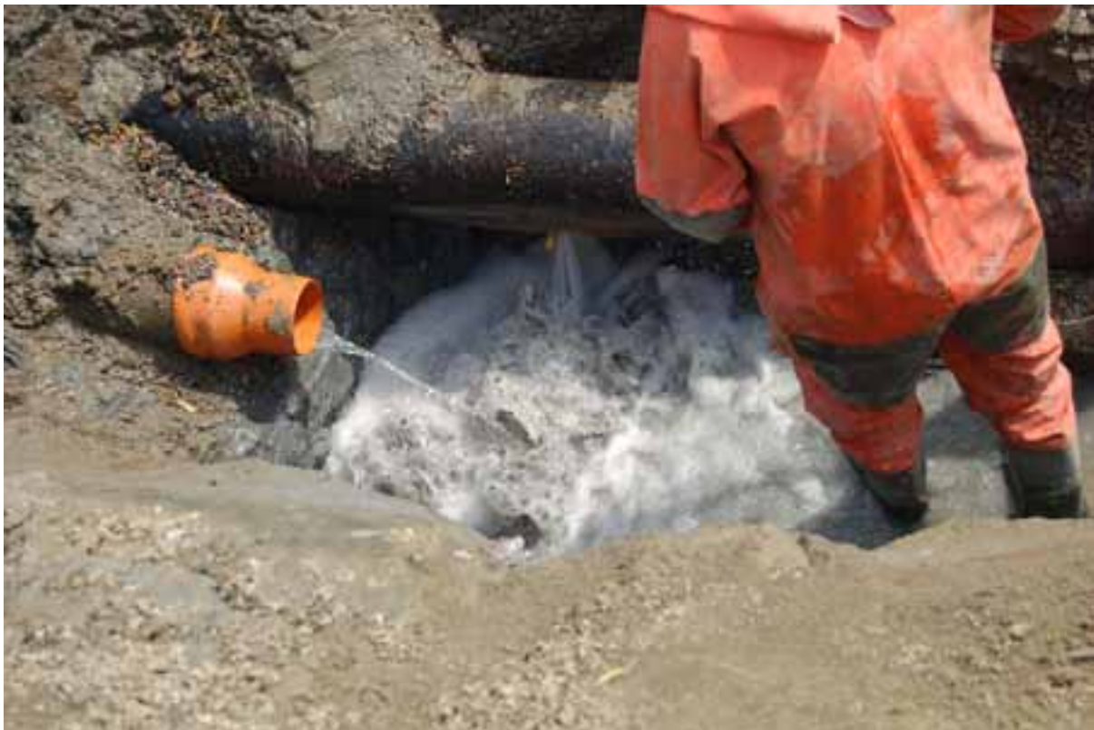
Figur 1. Vannlekkasje Hårberg, Lier kommune (Foto: Rene Astad Dupont, GVD)
