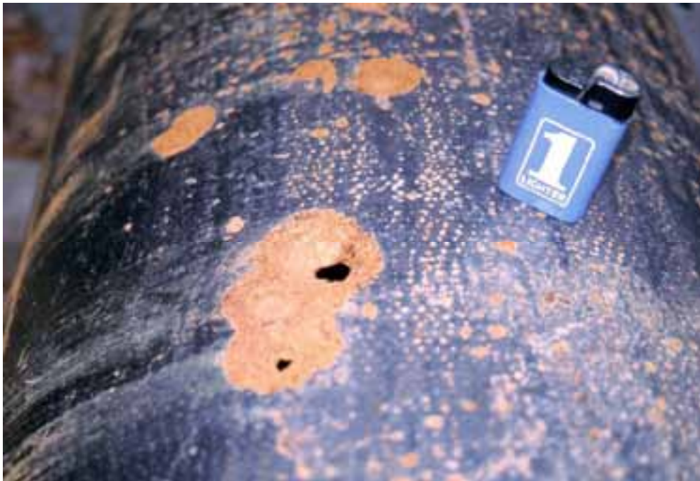
Figur 6. Rusthull, vannrør Porsgrunn kommune (Foto: Arve Hansen)
