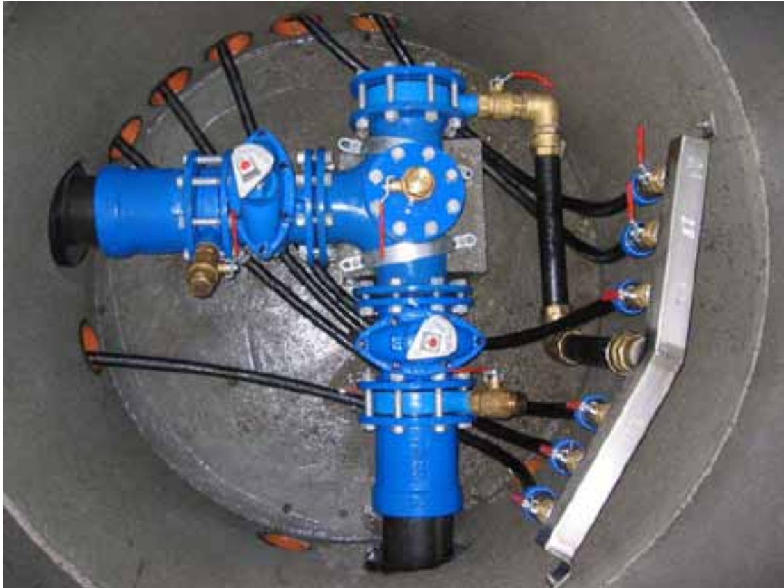
Figur 10. Vannkum fra Voss kommune med bruk av mellomringer og tilknytning av stikkledninger i kum med fordeler. (Foto: Jakob Håheim, Voss kommune)
