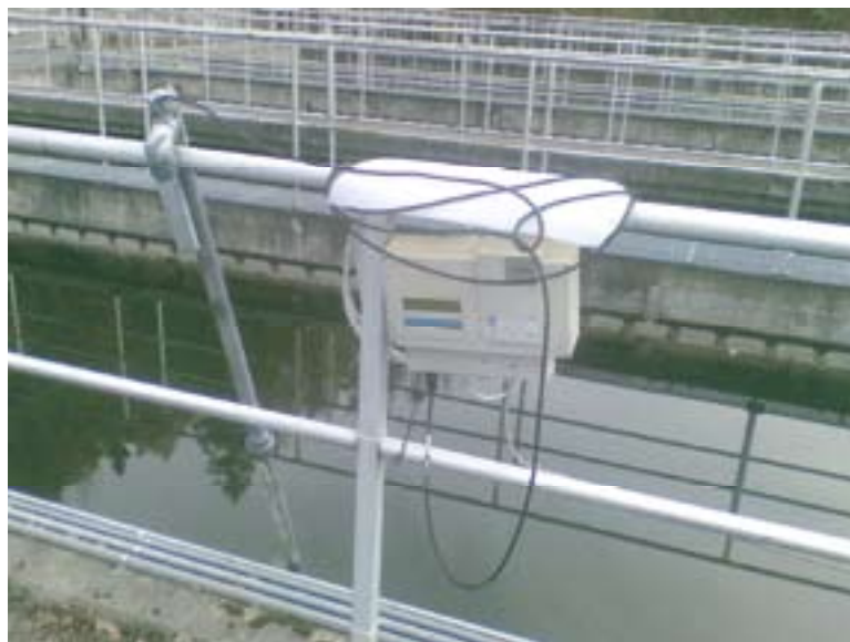
Figur 11. Turbidimeter plassert ved sedimenteringsbassenget
