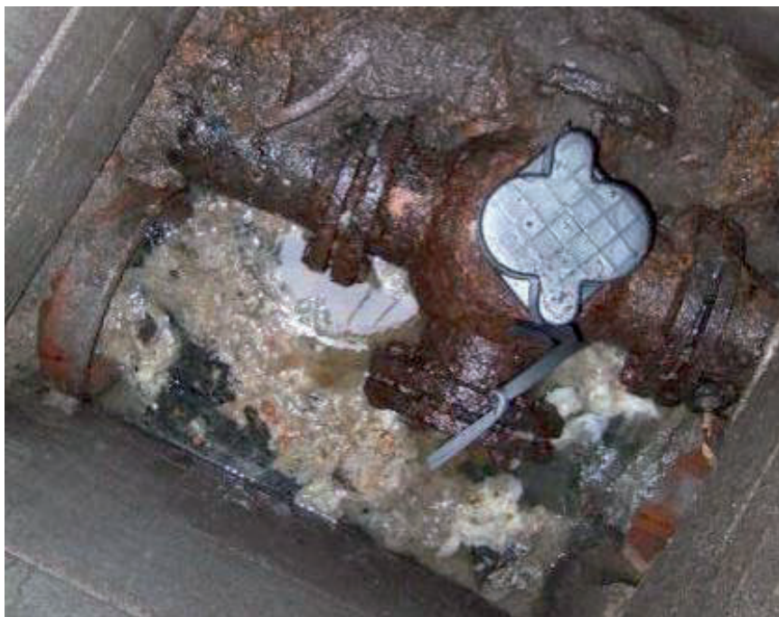
Figur 5: Kumarmatur utsatt for korrosjon
