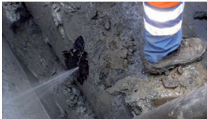
Figur 3: Avdekket korrosjonshull: Er dette et eksempel på skade som repareres under trykk?
