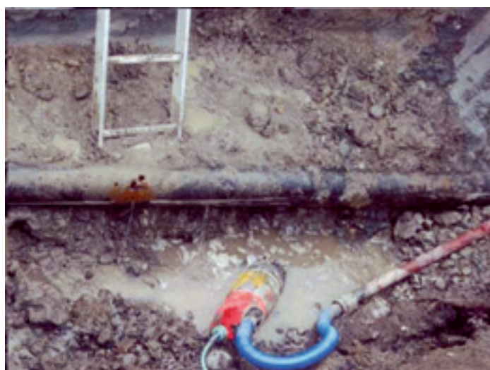
Figur 12: Drenering er en forutsetning for å oppnå hygienisk tilfredsstillende lekkasjeutbedring.
