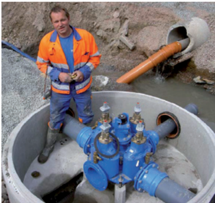
Figur 9: Et eksempel på at moderne vannkummer bygges med fokus på gode arbeidsforhold og høy hygienisk sikkerhet.
