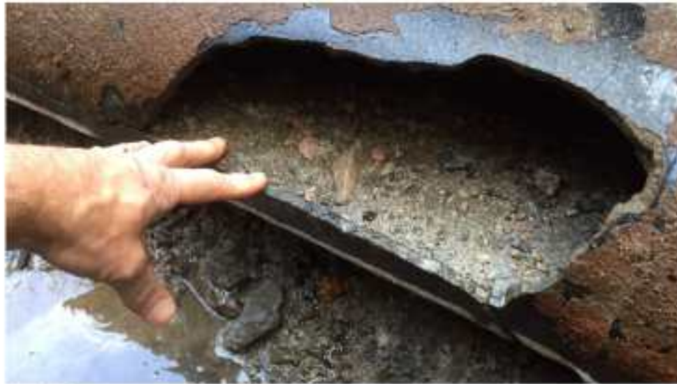
MANDAL: Gamle vannrør i støpejern fra 1957. FOTO: KA/STOKKELAND / NRK
