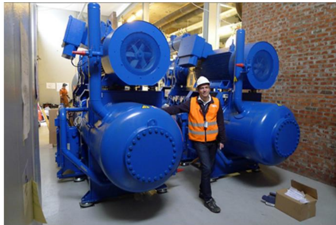
Bruker avløpsvann som kilde til 3 MW varmepumpe
